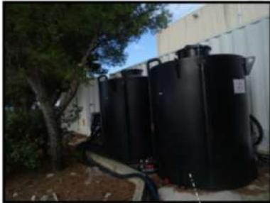
Cuve d'eau filtrée et recyclée
