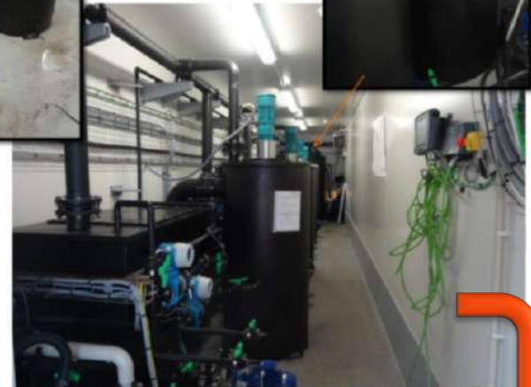
Vue intérieure du conteneur d'extraction
