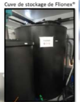
Cuve de stockage de Flionex®
