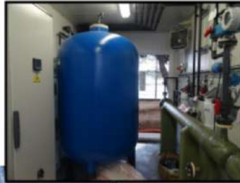
Conteneur post-traitement : filtre à sable et coalesceurs
