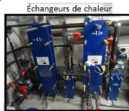
Échangeurs de chaleur
